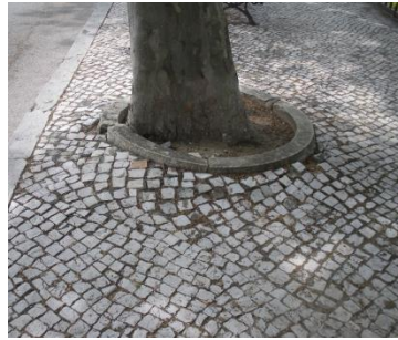
Figura 23 - Pavimentos irregulares e destruídos devido à ação das raízes das árvores
