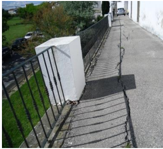
Figura 22 - Fendilhação e deformação do pavimento. Alto da Boa Vista
