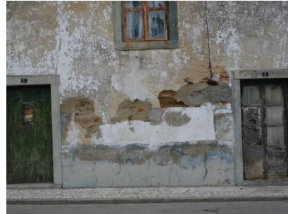
Figura 7 - Exemplo de edifícios com patologia muito grave ao nível das paredes exteriores
