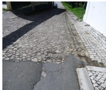
Figura 26 - Transição entre pavimentos mal executada. Largo do Jogo da Bola
