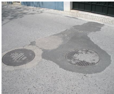
Figura 25 - Pavimentos irregulares, derivado a várias intervenções
