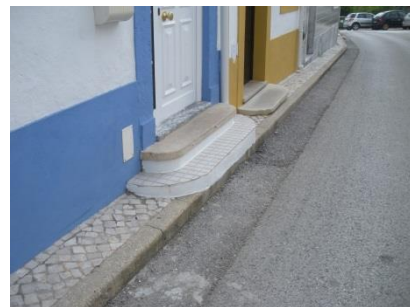
Figura 33 - Elementos construtivos que impedem a circulação nos passeios
