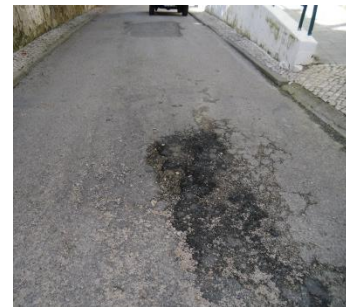
Figura 27 - Pavimento betuminoso em mau estado de conservação. Ladeira do Rio
