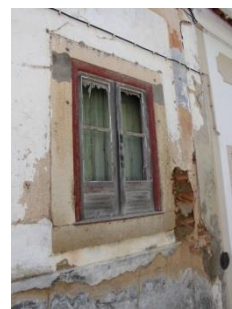
Figura 8 - Exemplo de edifícios com patologia muito grave ao nível da caixilharia
