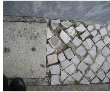
Figura 24 - Pedras de calçada soltas
